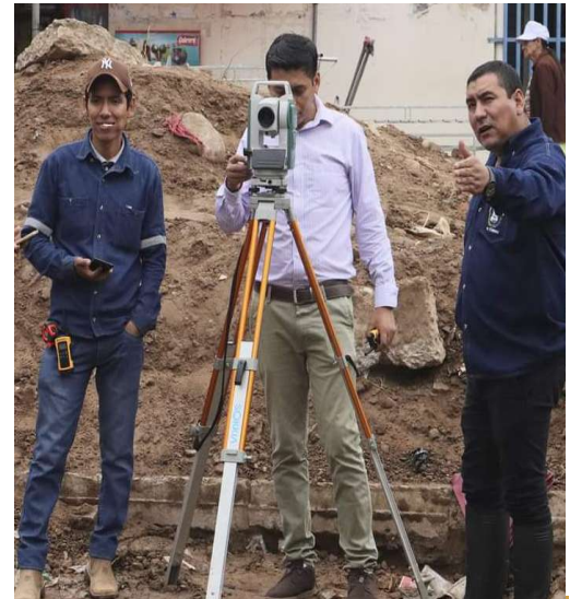
Replanteo Topográfico para el Enlosetado de las Calles Adyacentes al Mercado Municipal
